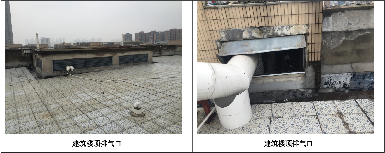
图 4-1-4 废气治理环保设施现场照片
