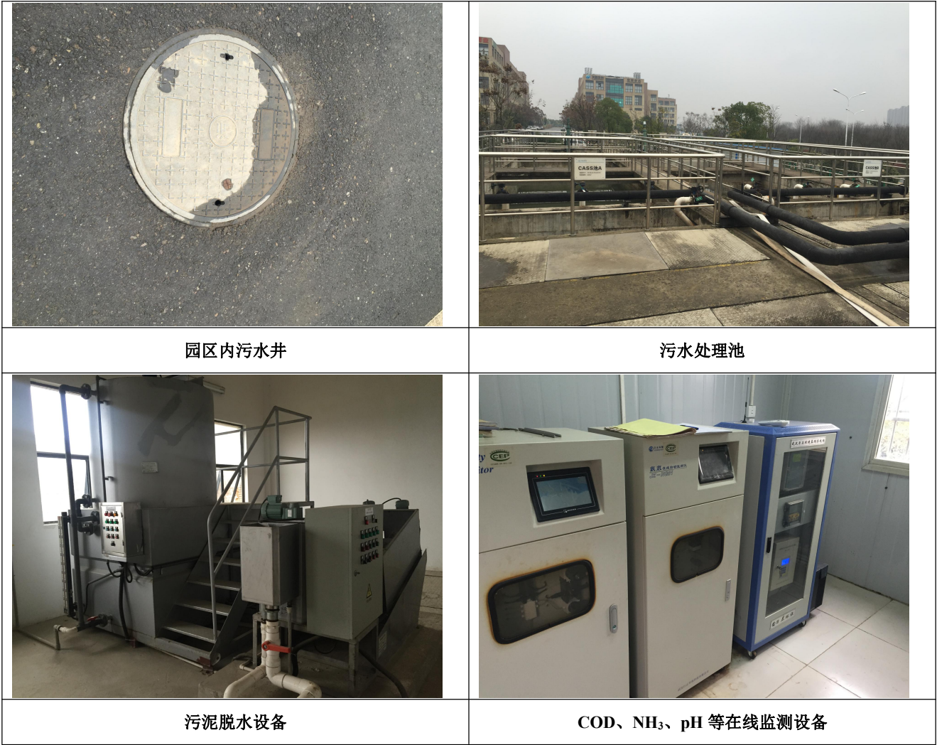
图 4-1-3 废水治理环保设施现场照片
