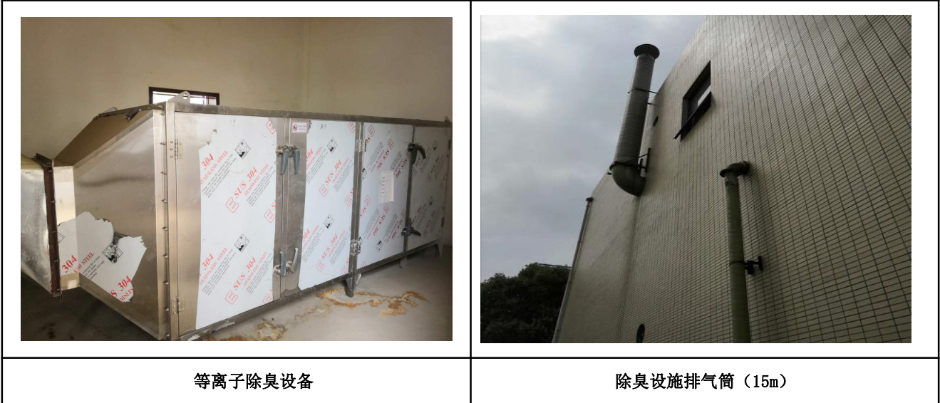
图 4-1-6 除臭系统现场照片
